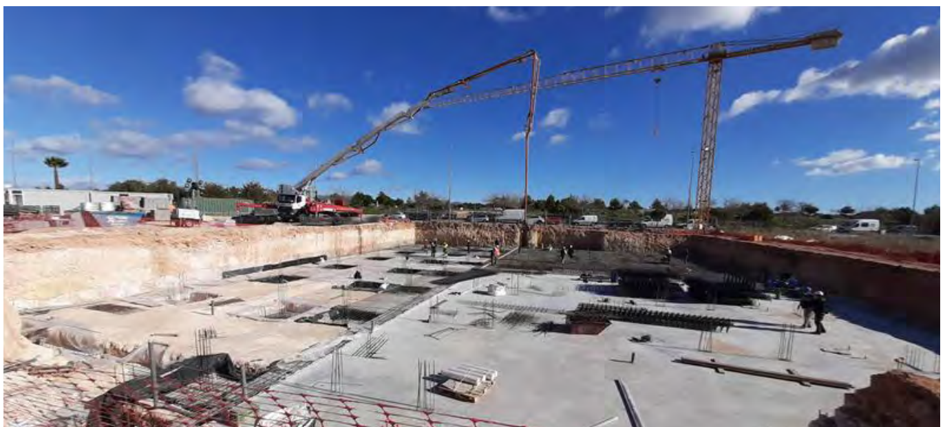
Foto: Trabajos de construcción de una promoción desarrollados por Árqura Homes en la Comunidad Valenciana.
